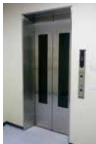
エレベータ(3基)
