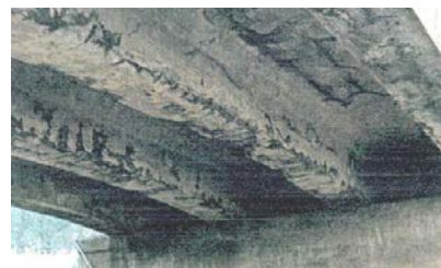
塩害劣化の状況
