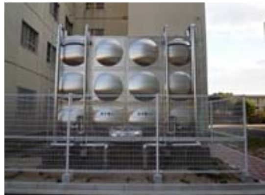
写真 3 学寮の水タンク
