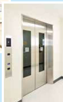
エレベータ (4基)
