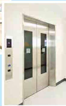
エレベータ (4基)
