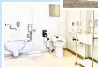
バリアフリー トイレ(5箇所)
